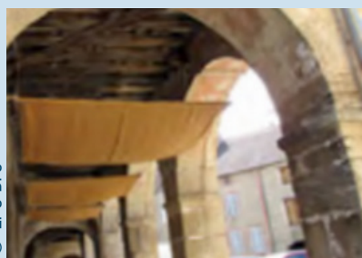
Bâches en tissu recueillant les fientes sous un porche commerçant à Noyers-sur-Serein (89).
